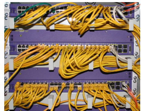
Abb. 6: Summit X450a-48t im Unterverteiler (3er Stack, jeweils mit redundanter PSU)
